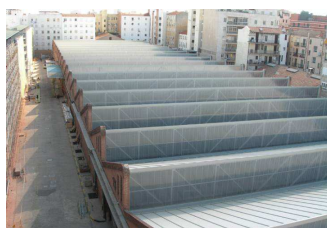
La cubierta de panel sandwich y policarbonato del Parque Móvil del Estado, en la calle madrileña de Cea Bermúdez. INDAFER
